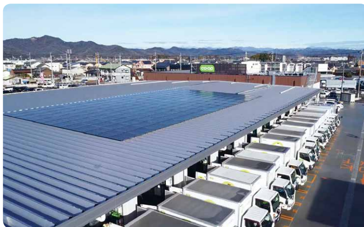
2024年1月に開設した佐野センターの屋根にも太陽光パネルが設置されました
